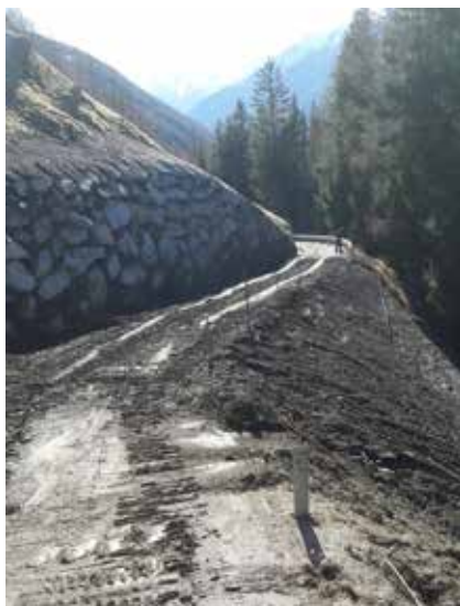
Straße Großklausen Sanierung Teilstück aufgrund von Unwetter-schäden
